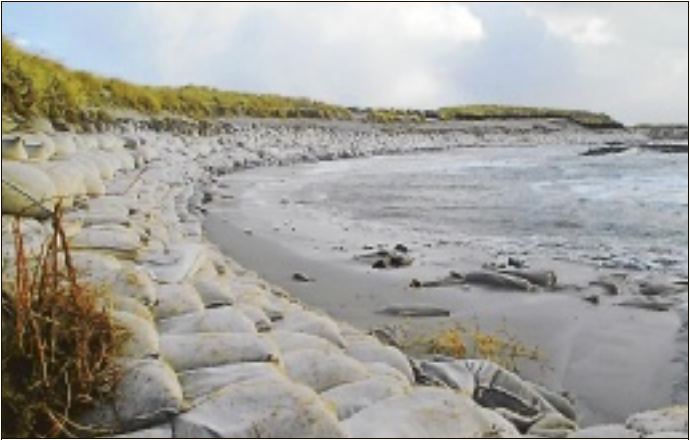
Im Westen der Insel Wangerooge wurden die Sandsäcke, die den Dünenfuß verstärken, freigelegt.
